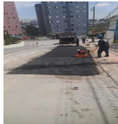
Resolução: Infiltração e vazamento saneados
