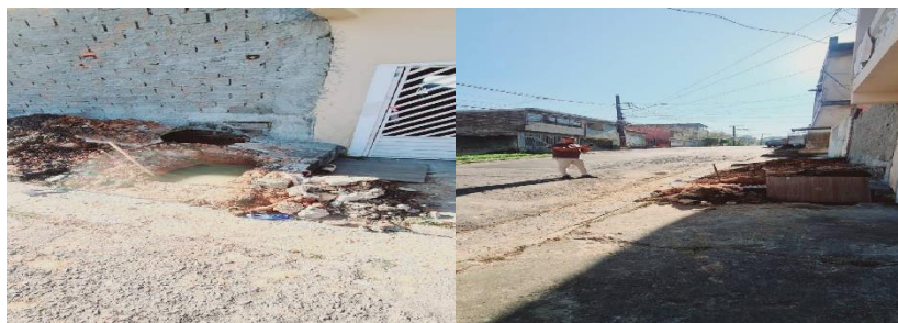
Motivo do Chamado – Vazamento na calçada
