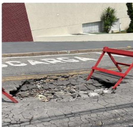
Chamado: Infiltração e vazamento
